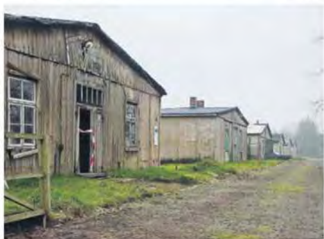
Die Bausubstanz der noch existenten Lagerbaracken hat erheblich gelitten. Erste Sicherungsmaßnahmen sichern den Bestand der unter Denkmalschutz stehenden Bauten.
