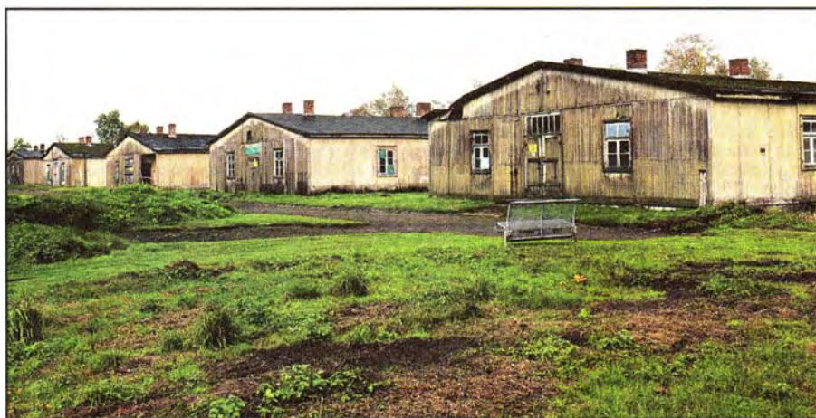
Sanierungsbedürftige Baracken des ehemaligen Kriegsgefangenlagers Sandbostel.
