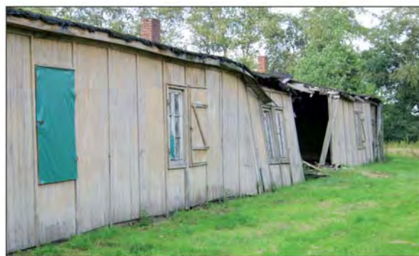
Hier gibt es für die Stiftung noch jede Menge zu tun: Als nächstes sollen die maroden Baracken saniert werden. Fotos: Zimmering
